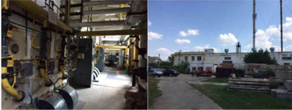
Малюнок 2.2 Котельня № 6 і котли КВГ-7.56
